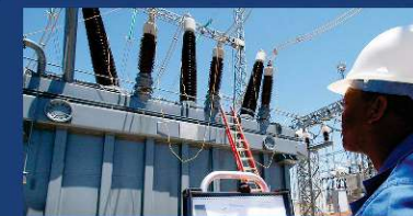
JARINGAN LISTRIK ELECTRICAL NETWORK
