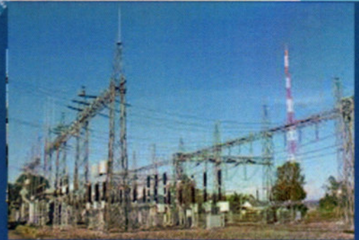
JARINGAN LISTRIK ELECTRICAL NETWORK
